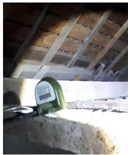
Micro installé dans le comble
