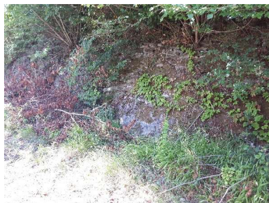
Talus empierré partiellement envahi par la végétation
