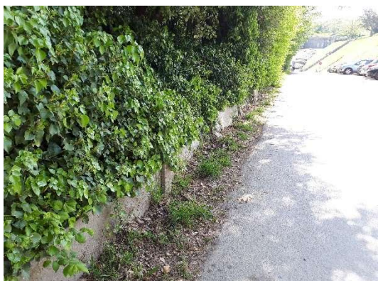
Lisière du talus (plaque béton et envahissement par le lierre)
